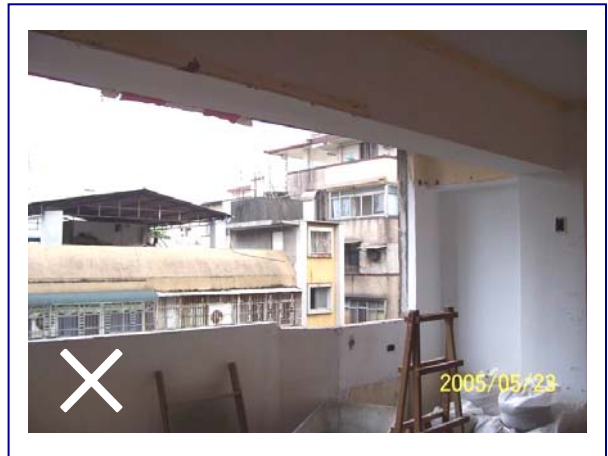
▲ 擅將外牆拆除「陽臺外推」係屬違建行為。
