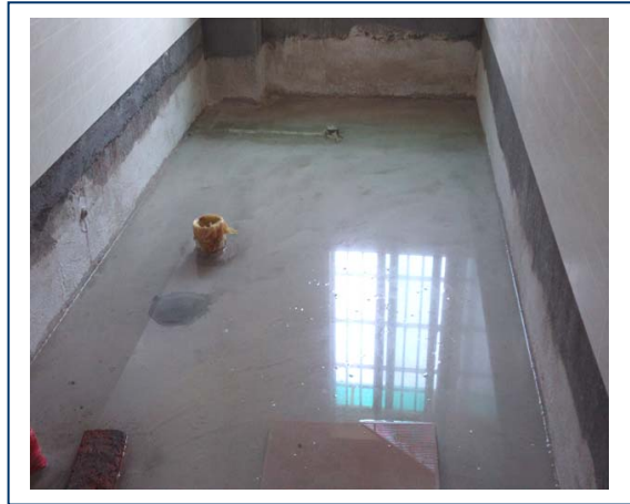
▲ 防水層施作完畢後，須做 24 小時蓄水試驗，查核有無漏水現象。
