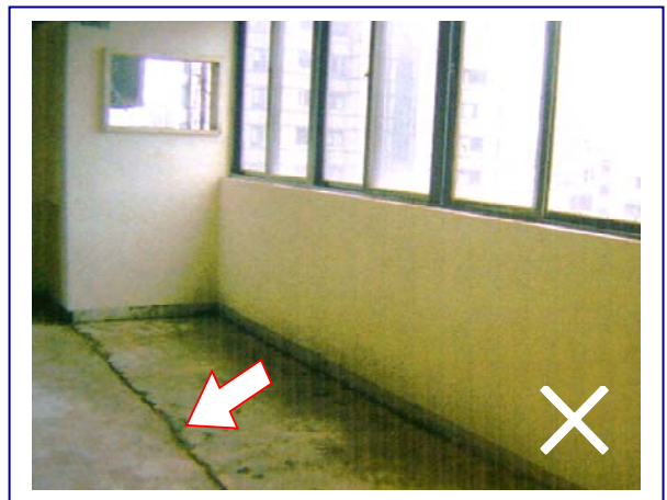
▲ 擅自拆除陽臺外牆，導致陽臺根部開裂之案例
