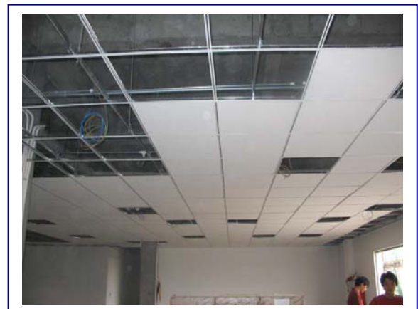
▲ 具有檢修功能的輕鋼架天花板
